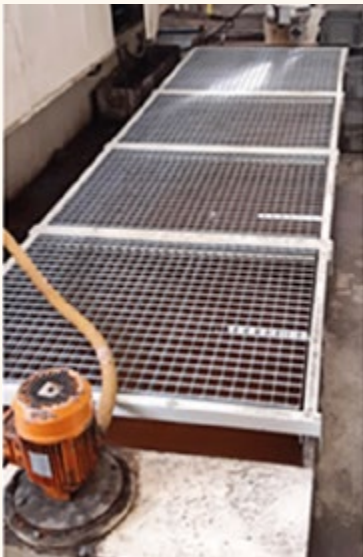
Installation nach Modifikation
