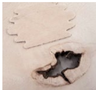
Defekt vor der Reparatur
