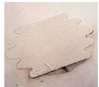
Defekt nach der Reparatur
